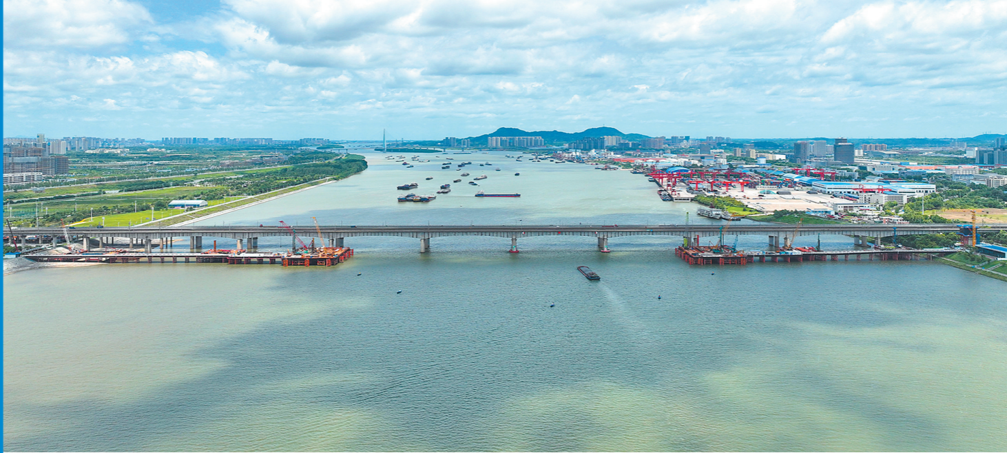
长沙湘江铁路特大桥是长赣高铁全线的控制性工程。长沙晚报全媒体记者 黄启晴 通讯员 肖青青 王攀登 摄影报道
